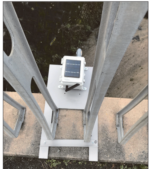
樋井川でモニタリング中の河川水位センサーノード
